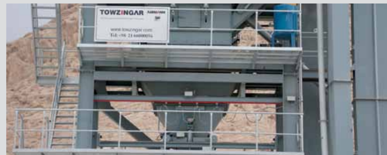
اسکیپ و سیلوی ذخیره آسفالت Skip & asphalt storage silo
