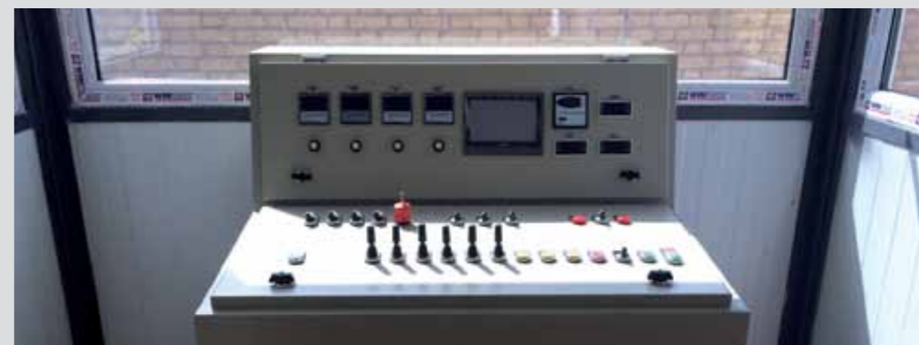
کنترل و مانیتورینگ با میز پیاپی و نمایشگر HMI Controlling and monitoring through control desk and HMI display
