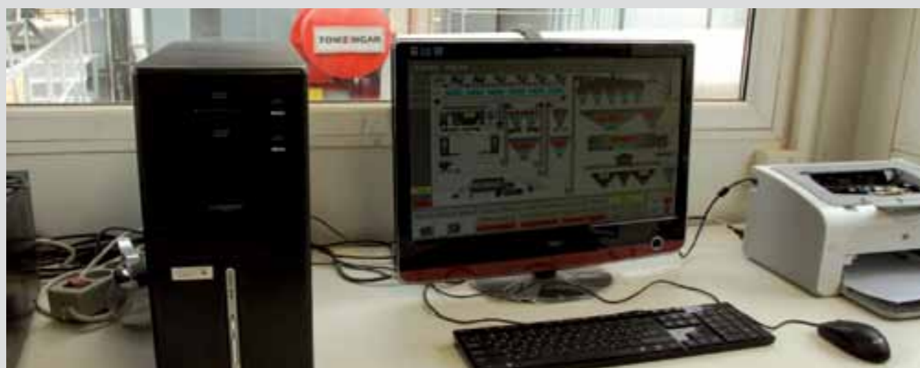
کابین کنترل Control cabin
